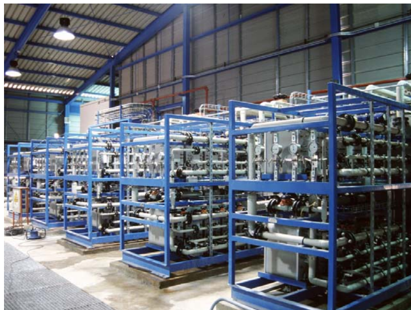
Foto 5. Equipos modulares de electrodesionización en continuo para producción de agua desionizada para calderas de alta presión (producción 2850 m 3 /día)
