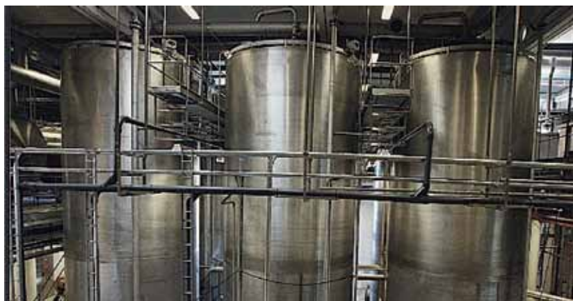
Planta de tratamiento de aguas industriales farmacéuticas de AstraZeneca (Suecia)
