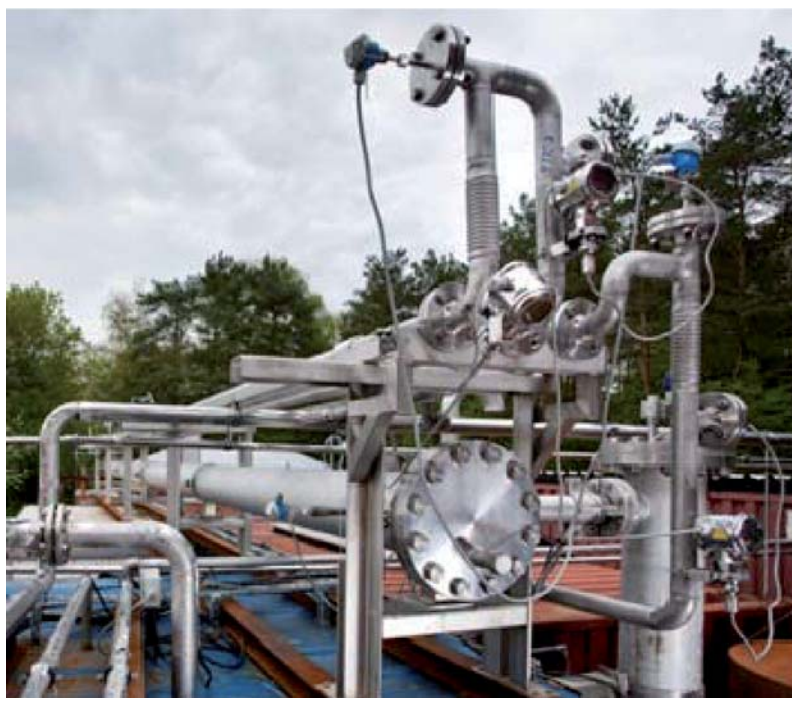
Figura 2. El sistema de demostración de hidrólisis térmica continua Exelys instalado en Hillerød, Dinamarca. El sistema no ha sido aislado y, por lo tanto, se pueden apreciar claramente las características de diseño
