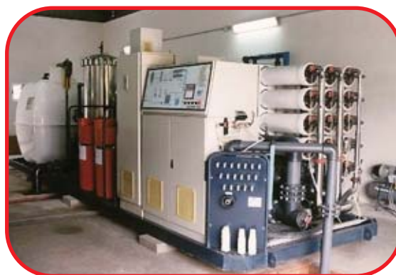
Instalación de ósmosis inversa para eliminación de sales para una población de 8.000 habitantes.
