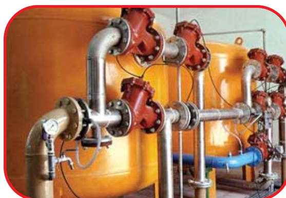
Filtración doble etapa para eliminación de turbidez, hierro y manganeso para una población de 15.000 habitantes.
