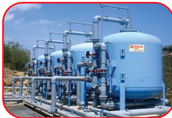
Instalación de filtración para eliminación de arsénico para una población de 20.000 habitantes.
